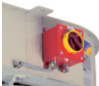
Caixa de ligações no exterior. Pés de fixação.
