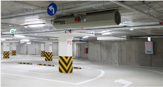
PYSÄKÖINTIHALLIN ILMANVAIHTO Hotel Sheraton Grand Tbilisi Palace, Georgia
